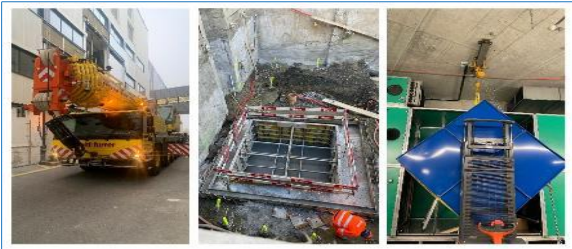
Abbildung 11: Beispiele unterschiedlicher gefährlicher Arbeiten im Bereich der Baustellensicherheit
